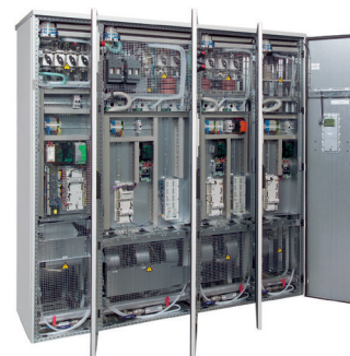
Système électrique © ABB
